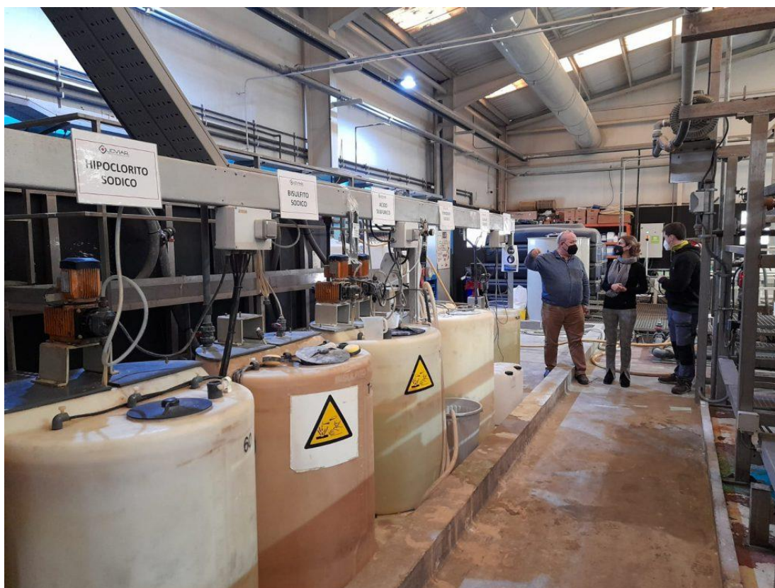
AIDIMME visita las instalaciones de depuración, desmineralización y líneas de acabados electrolíticos de Joviar
